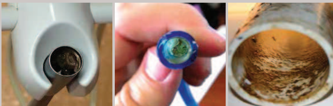
Zdj. 2. Przewody jednostki stomatologicznej
